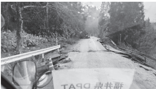
穴水から先では、 道路両側が崩れた場所が多数みられた
